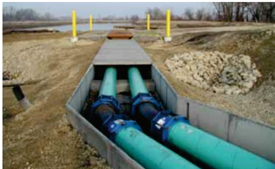
Figura 45. Aplicación de zanjas de tuberías de concreto reforzado con fibra de vidrio. Cortesía de Nippon Electric Glass America Inc
